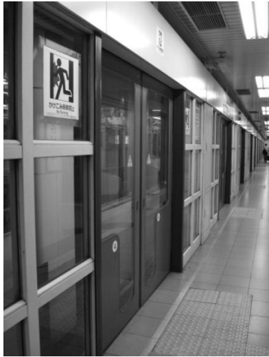
写真1「東西線各駅に設置されているホームドア」
